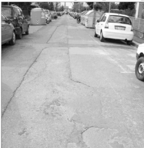
Via Puccini Continua ad essere una strada piena di buche e dossi causati dai numerosi cantieri che hanno interessato i sottoservizi negli ultimi mesi (foto Bauermann)
